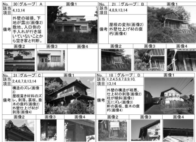
図 4 グループ別危険空き家
