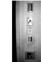
写真5 DKの非常用ブザーと温水器のリモートコントロール
